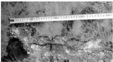
Poškodba na steni vodne celice zaradi korodiranja armature.
