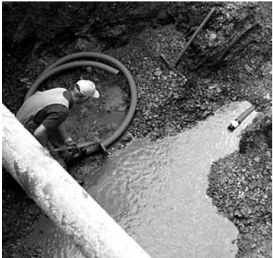
Sondažna jama pri vodohranu – zajeta voda je uhajala iz vodohrana
