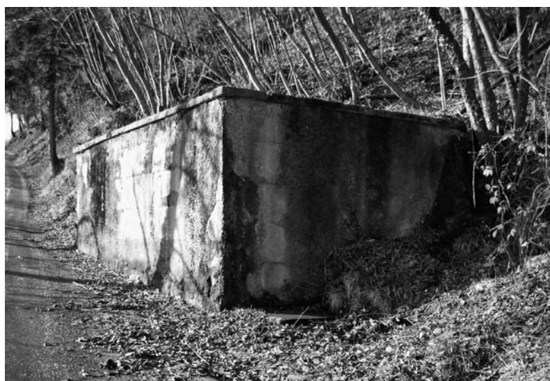
Vodohran za vas Orehek pred sanacijo
