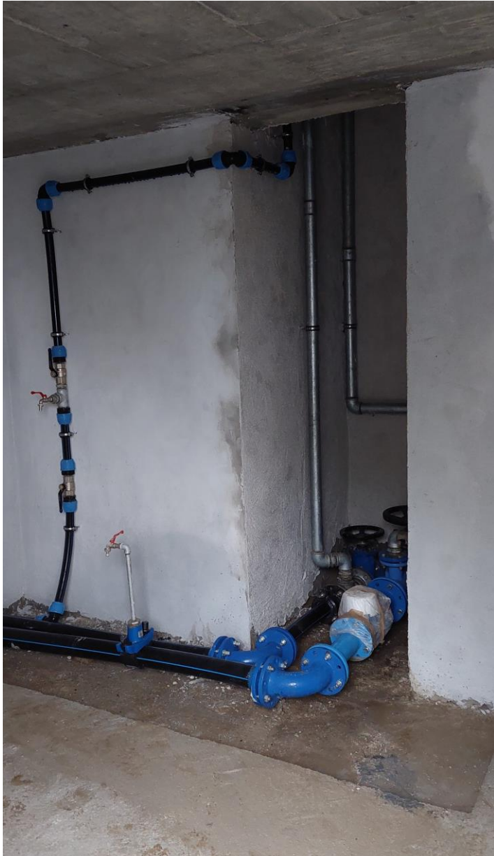
Nove vodovodne armature v suhem delu vodohrana Travnik
