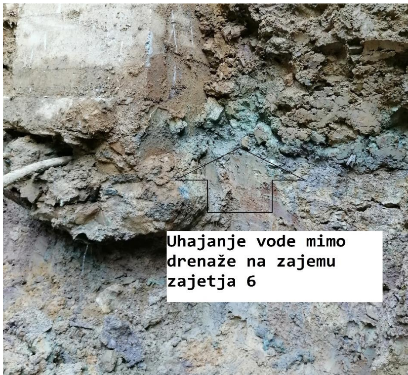
Levi rob obstoječega jaška kjer uhaja voda mimo drenaže
