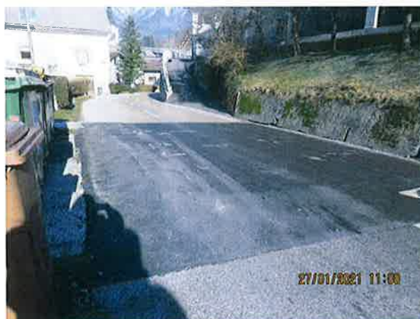
Slika št. 8: Gradnja naprave za umirjanje prometa v neskladju s tehnično specifikacijo za javne ceste TSC 02.203:2009
