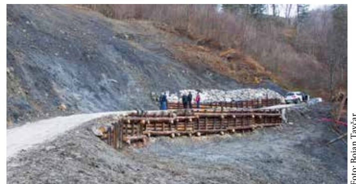
Saniran plaz na cesti v Hudajužno
